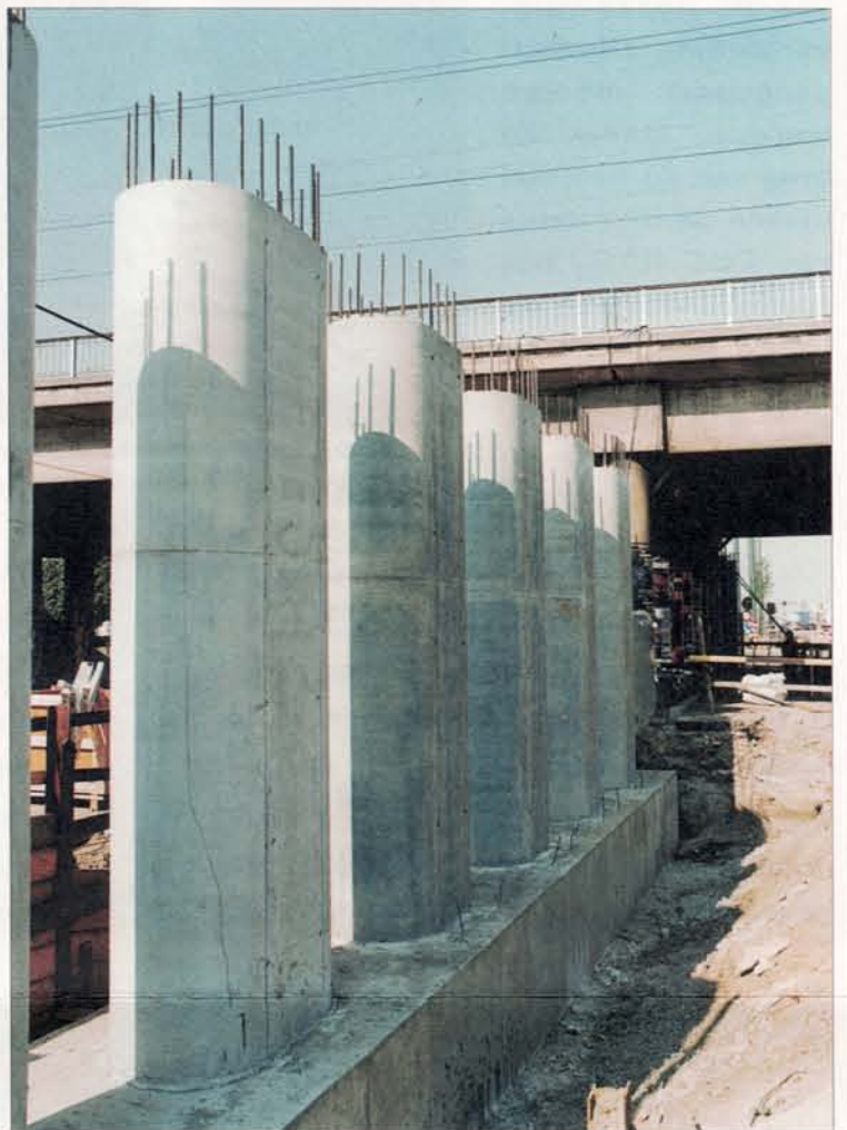
Voor het plaatsen van de funderingspalen van de nieuwe bruggen en het verleggen van de nutsleidingen moest de verkeerssituatie op de Groenendaallaan een aantal maanden gewijzigd worden. De funderingen zijn intussen klaar en de verkeerssituatie verloopt opnieuw normaal.
